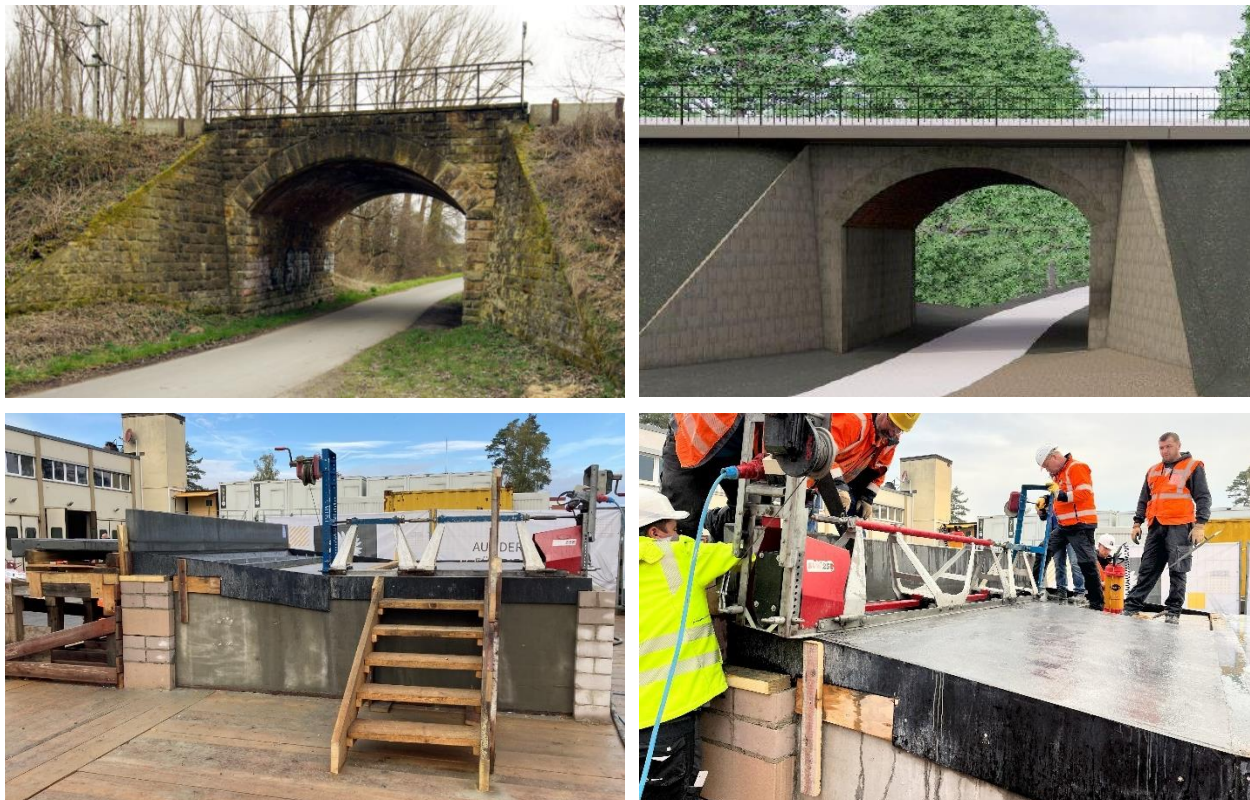
Abbildungen 25, 26, 27, 28: Aktueller Zustand der EÜ zw. TG-MLK (oben links) und Visualisierung nach der optisch zurückhaltenden Teilerneuerung mit eingefärbtem UHFB (oben rechts) des denkmalgeschützten Bauwerks. Herstellung des UHFB-Probebauteils (unten links) und Testen des Einbaus, der Verarbeitbarkeit und Nachbehandlung von UHFB, hier im 10 %-Gefälle (unten rechts) (Fotos: MKP GmbH, Okt. 2023; Visualisierung oben rechts: ICL Rail GmbH).
