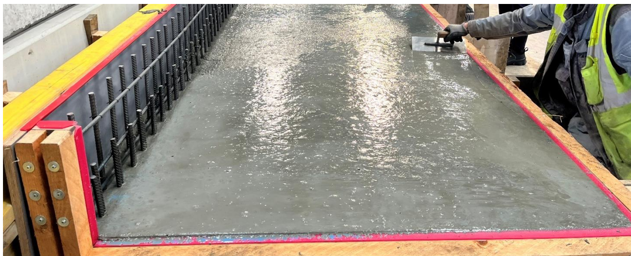
Abbildung 4: Abziehen einer frischen UHFB-Schicht mit Kelle, das Herausziehen von Kurzfasern wird durch den Auftrag einer Glätthilfe (blaue Flüssigkeit) verhindert (Foto: MKP GmbH Oktober 2023)
