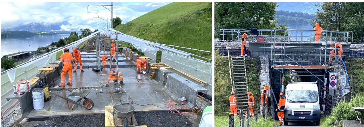
Abbildungen 11 und 12: links: Einbau der UHFBS-Trogelement (mit 50 mm Blechstärke) mit UHFBS-Vergießen der Quer- fugen; rechts: fertig eingebauter, bereits eingeschotterter UHFBS-Trog (Fotos: E. Brühwiler 16.07.2024).
