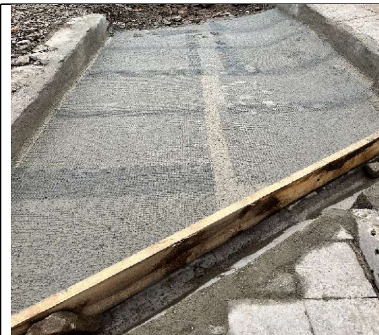
Abbildung 12: Kevag Viadukt – Applikation Textilbeton – hier: erste Lage Textilbeton und mittig eingelegte Bewehrung
